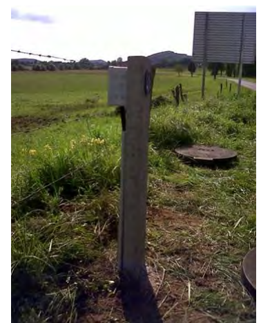
Antenne sur potelet
